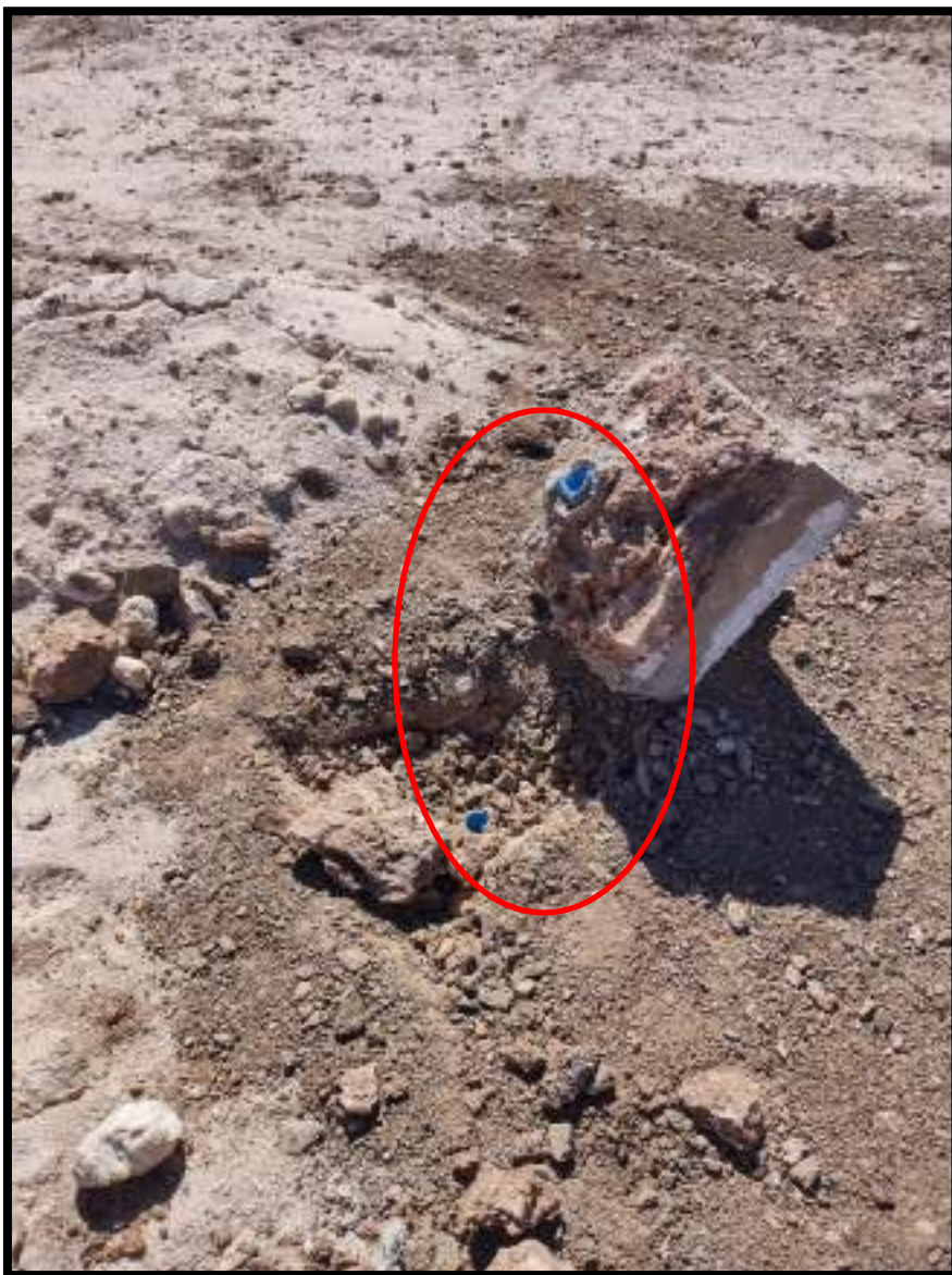
Figura 4: Daño en el PVC del pozo CL-26-1
