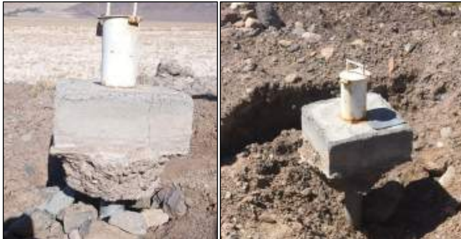
Ilustración 3. Vista de pozo MP-08A previo a las reparaciones
